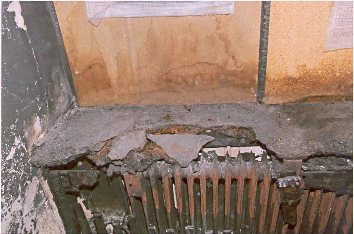
▲ Lichtbild 14 Das linke Fensterbrett im Krankenzimmer.
