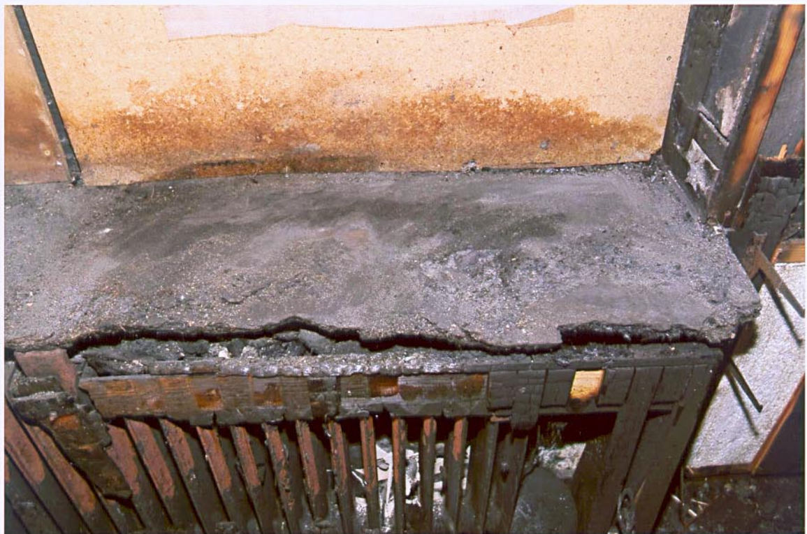
▲ Lichtbild 15 Das rechte Fensterbrett im Krankenzimmer.
