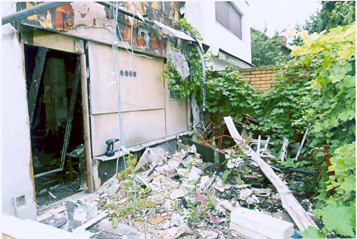
▲ Lichtbild 3 Brandschutt auf Terrasse
